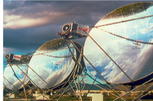
Capteurs thermodynamique paraboliques
