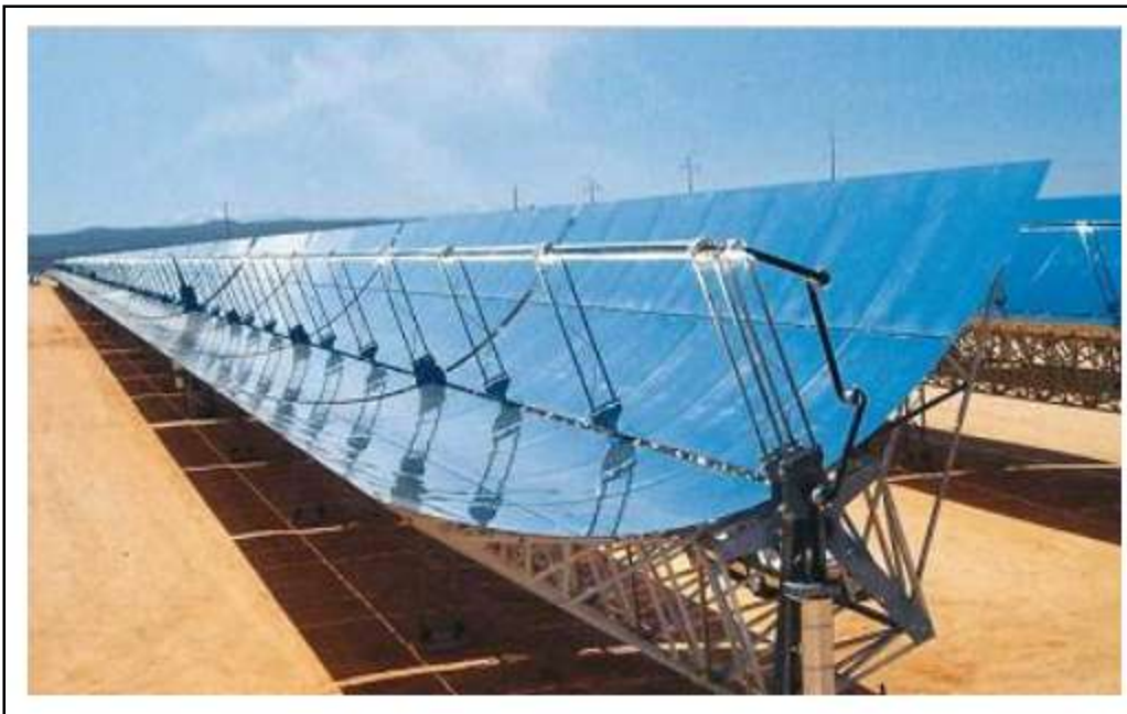
Figure 1.2 : Centrale constituée de capteurs cylindro paraboliques
