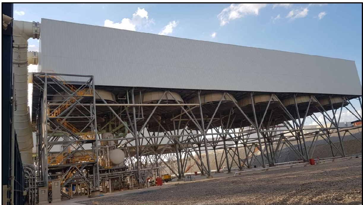
Figure 2.25 : Photo de l'aérocondenseur de la centrale d'Ain Arnat
