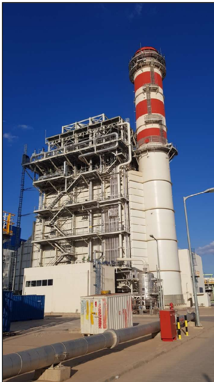
Figure 2.22 : Photo de la chaudière de récupération de la centrale de Ain Arnat
