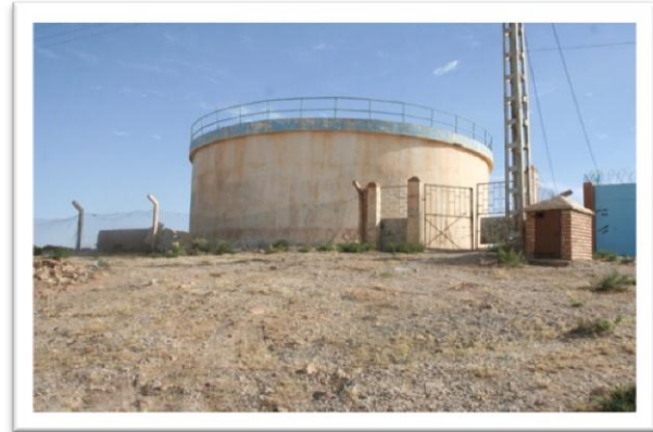
الصورة رقم (18): خزانات المياه
