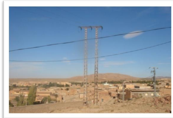
الصورة رقم (07): الخط الكهربائي
