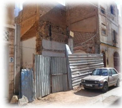
الصورة رقم (34) تدهور الواجهة العمرانية
