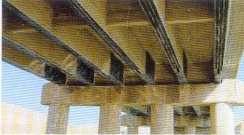
Figure.II.10. Renforcement vis à vis la flexion du pont en béton armé
