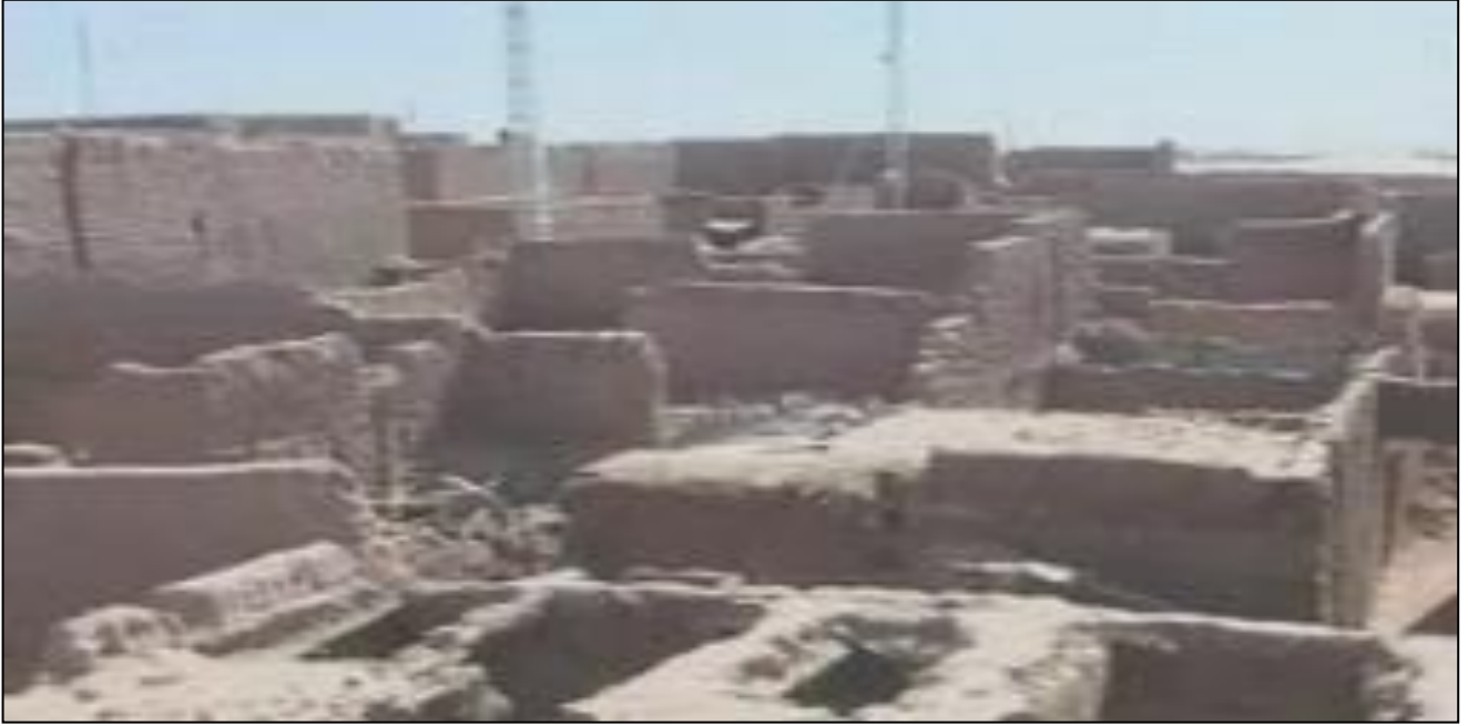
الصورة رقم(63):مساكن متضررة من نمط القصر (أولف، فيفري 2009)
