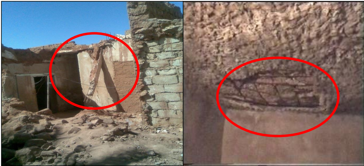
الصورة رقم (65): مساكن متضررة ذات مواد بناء حديثة (أولف، فيفري 2009)
