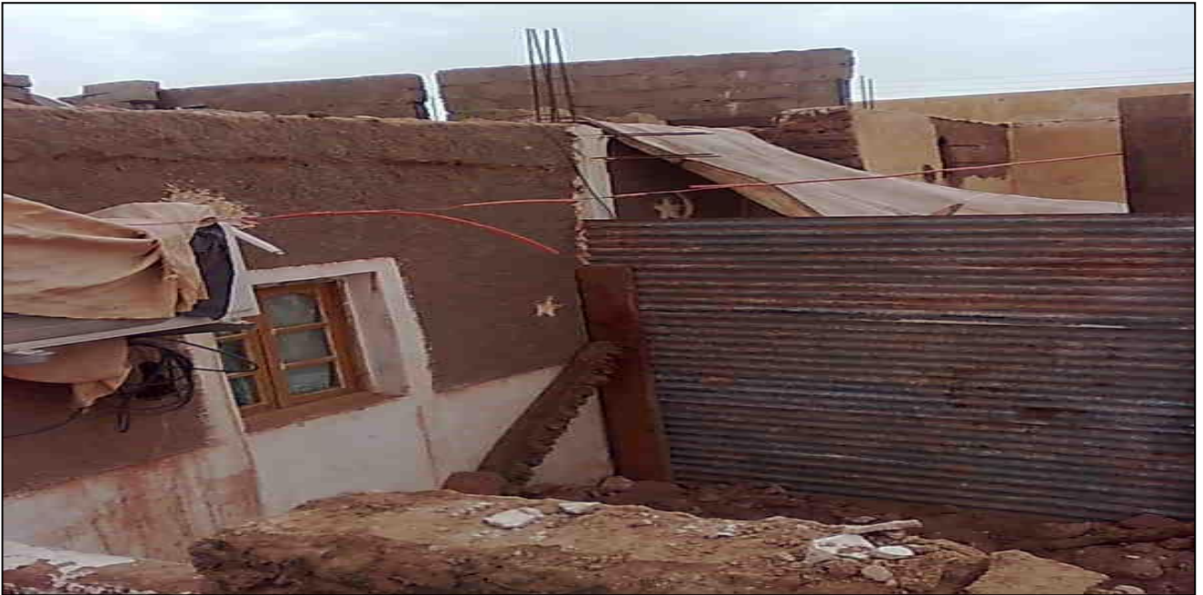
الصورة رقم(64):مساكن متضررة ذاتية البناء(أولف، فيفري 2009)
