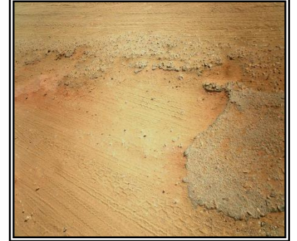
الصورة رقم (56) حالة الطرق سيئة
