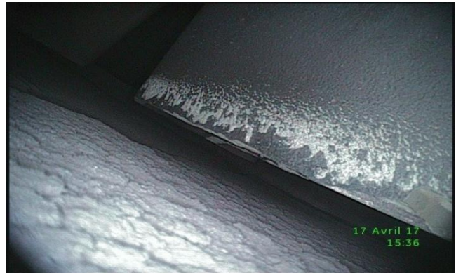
Figure IV:19 Surchauffe au niveau des extrémités des ailettes
