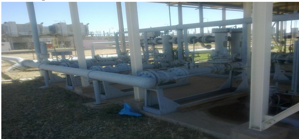
Figure III:2 Photo Poste de gaz dans central électrique M'Sila
