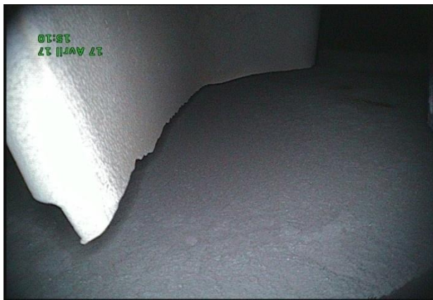
Figure IV:21 Erosion sur le sommet (extrémité) d'une ailette
