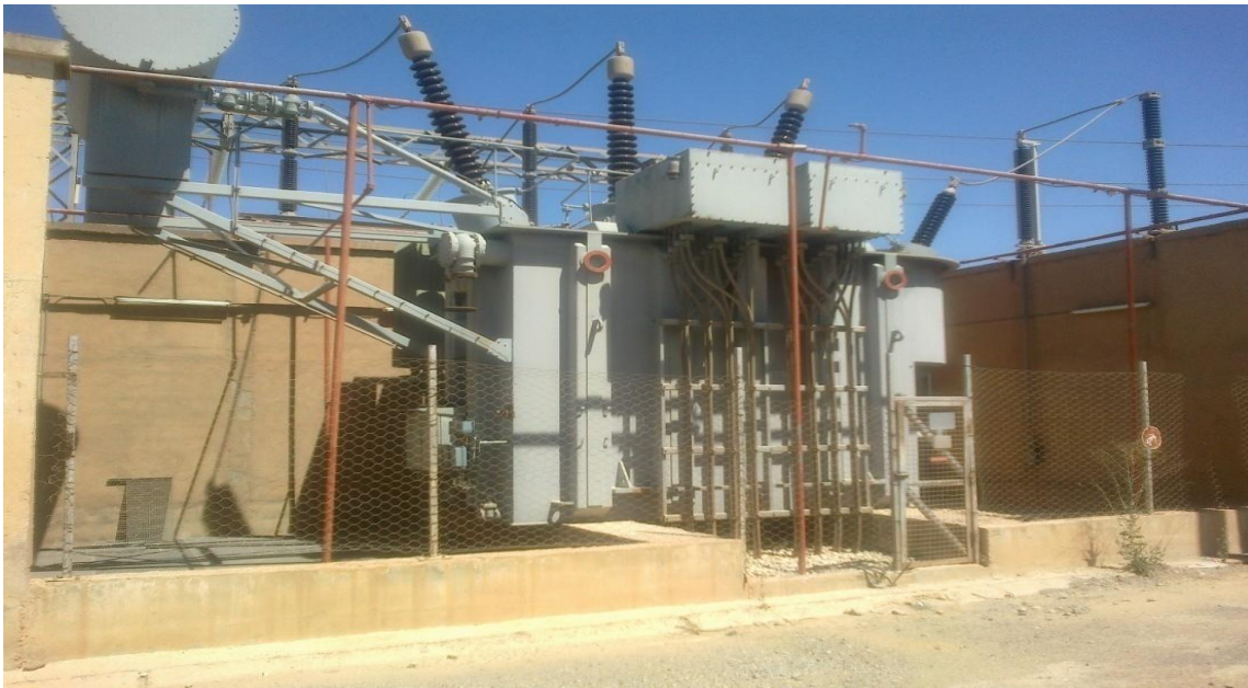
Figure III:11 représente transformateur principal 53 MVA TP21/22
