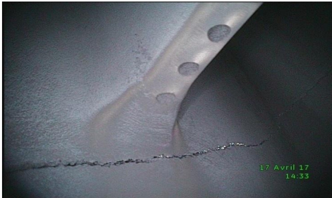
Figure IV:18 Fissure axiale au niveau du bandage d'une aube (côté bords de fuite)
