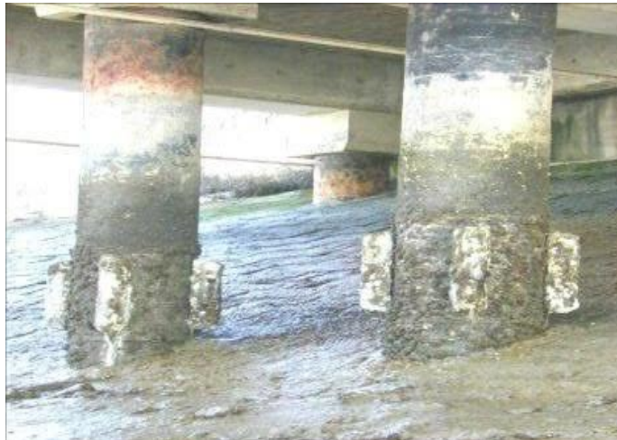
Figure I.10 pénétration des eaux de mer sur le béton[7]
