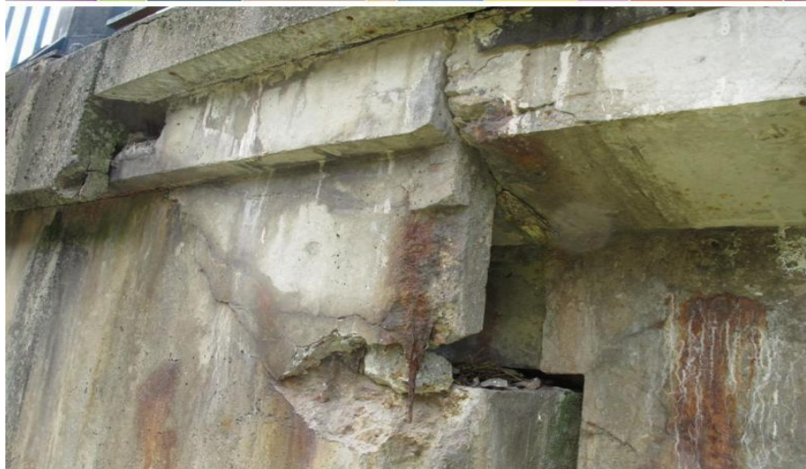
Figure I.2 phénomène de corrosion des armatures [2]
