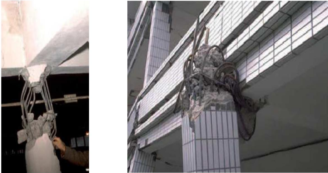
Figure (1-8) : Eclatement de zones critiques, extrémités des poteaux et poutres.
