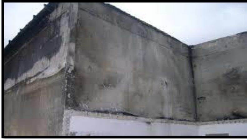
Figure II.9. Changement de couleur d'un bâtiment sous effet d'un incendie.
