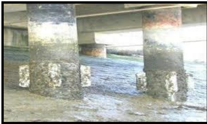
Figure II.1. Dégradation des pieux par attaque sulfatique.
