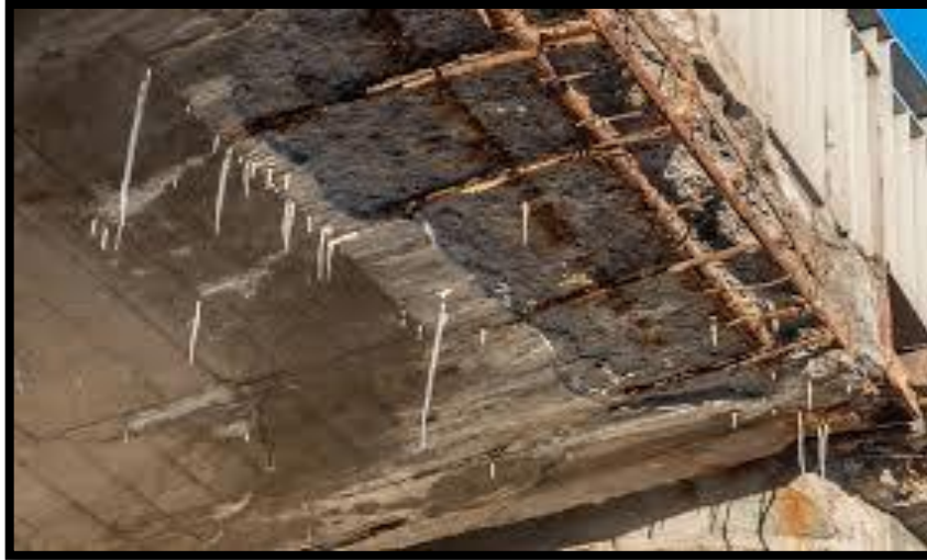
Figure II.7. Détérioration d'un revêtement de pont par attaque de gel.
