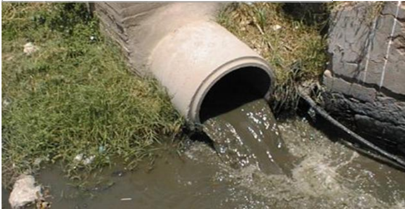
Photo n° 01 : les eaux usées rejetées dans la nature
