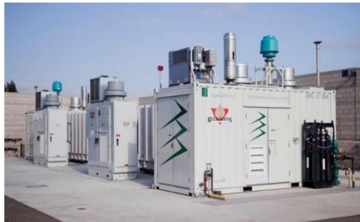
Figure I.6 : Unité de pile combustible
