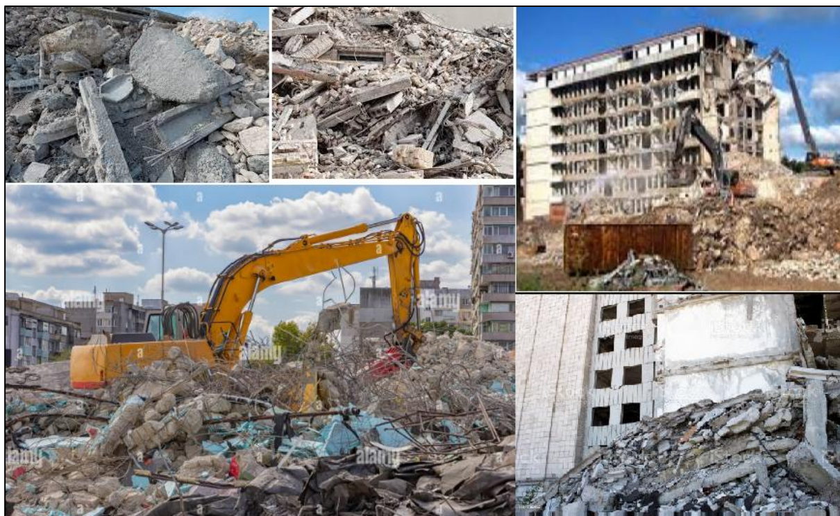
Figure I.1. Débris de la démolition des constructions.
