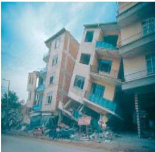
Figure II.8 : Destruction du RDC [8].
