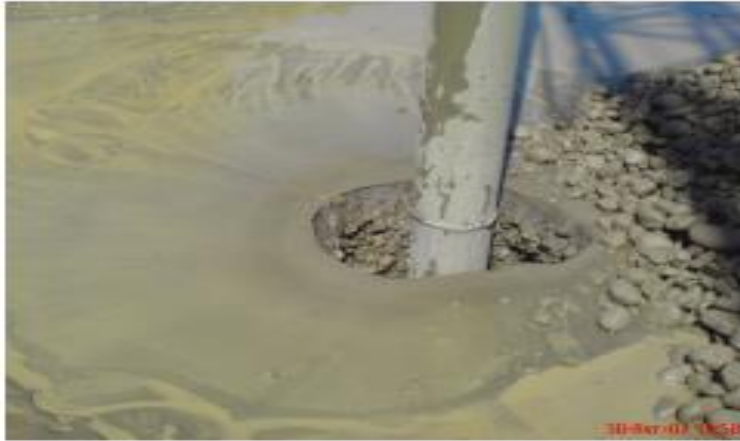
Fig I.33 - Phénomène de liquéfaction local
