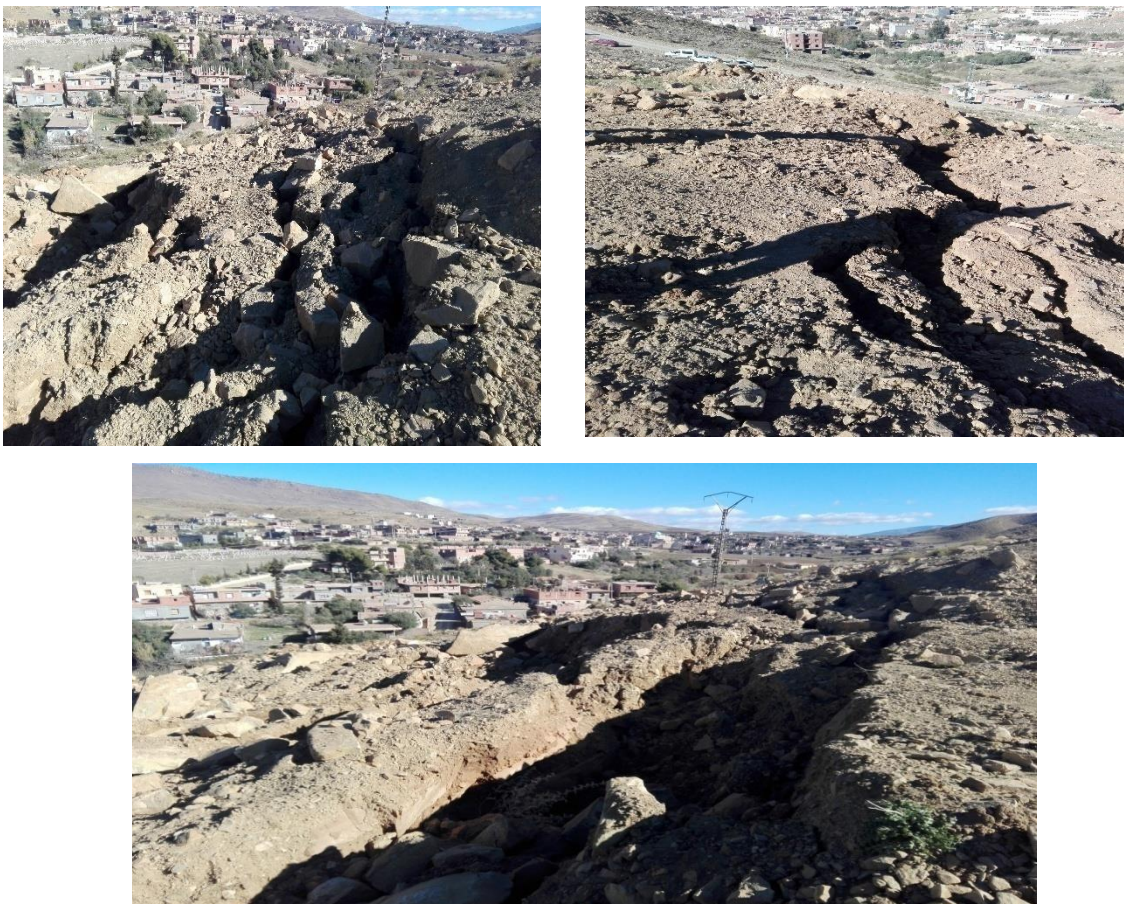
Figure III.2 Cas pathologique dus au glissement (Ouanougha 2020)
