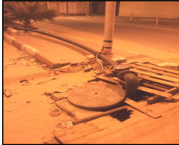
صورة رقم 23 : انسداد شبكة الصرف الصحي
