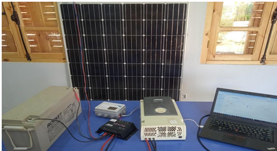
Figure III-27. Installation complète du système solaire avec surveillance environnementale en temps réel via Blynk.
