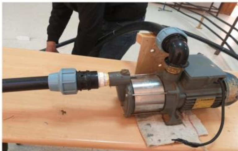
Fig.III. 8. Pompe à eau.
