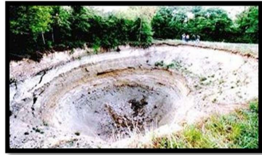
Figure II.6 : Fontis ayant atteint la surface [24].
