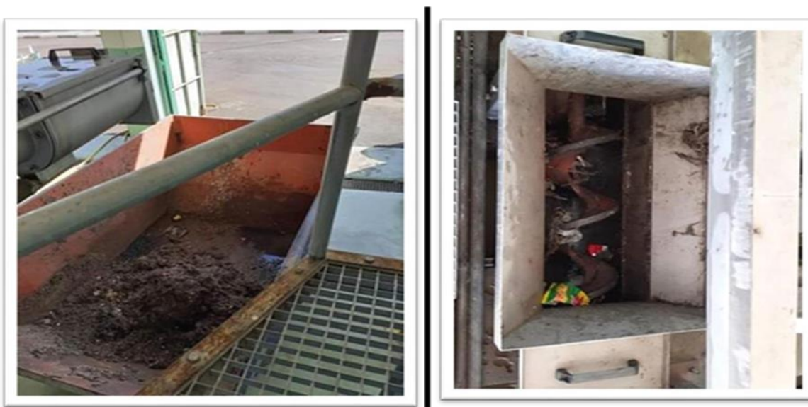
Figure II.11 : Les refus de dégrillage
