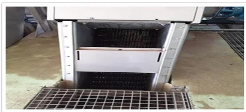
Figure II.10 : Dégrillage mécanisé fin
