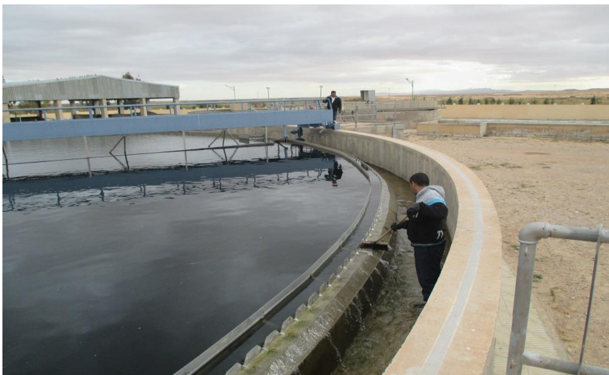
Figure II-15 : Modèle d'un Clarificateur (Photo de la STEP de la ville de Bou Saâda)
