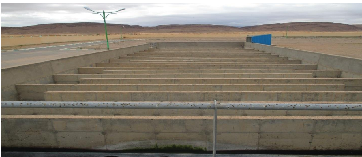
Figure II-16 : Bassin de chloration (Photo de la STEP de la ville de Bou Saâda)
