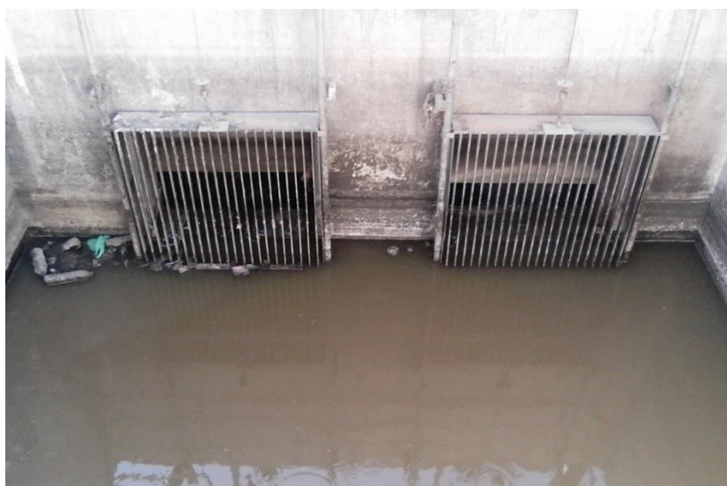
Figure II.9: Dégrilleur mécanique grossier
