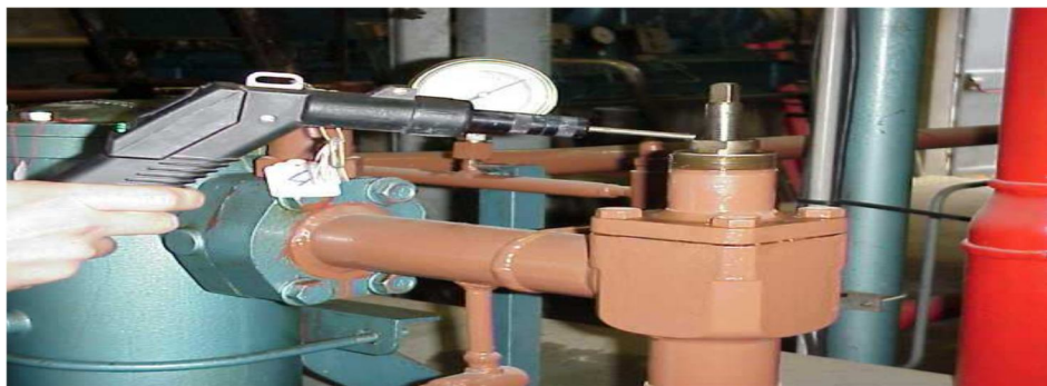
Fig. II.11. Déplacement de la sonde « au plus près » des zones potentiellement fuyardes
