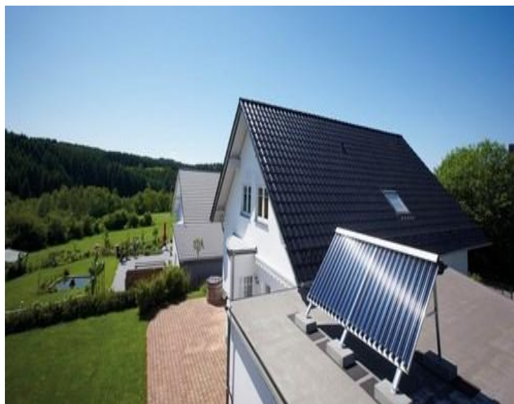
Fig. II.7 Installation d'un Capteur Solaire thermique
