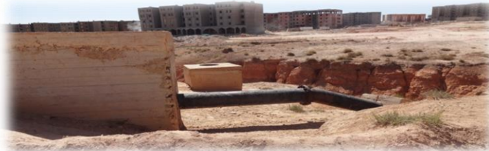
صورة رقم توضح قناة التغذية بالمياه الصالحة للشرب
