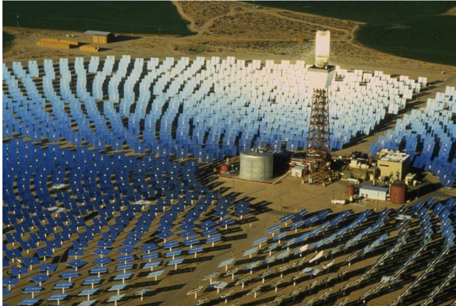
Figure. V.2 : Centrale à tour
