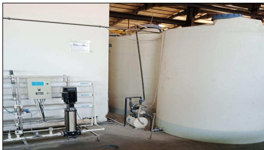
Fig.II.13.Le réservoir de traitement d'eau [document entreprise].
