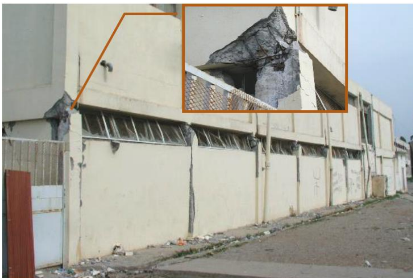
Figure II.13 : Cas de poteaux courts sans protection – tous les poteaux sont cisailés [31].
