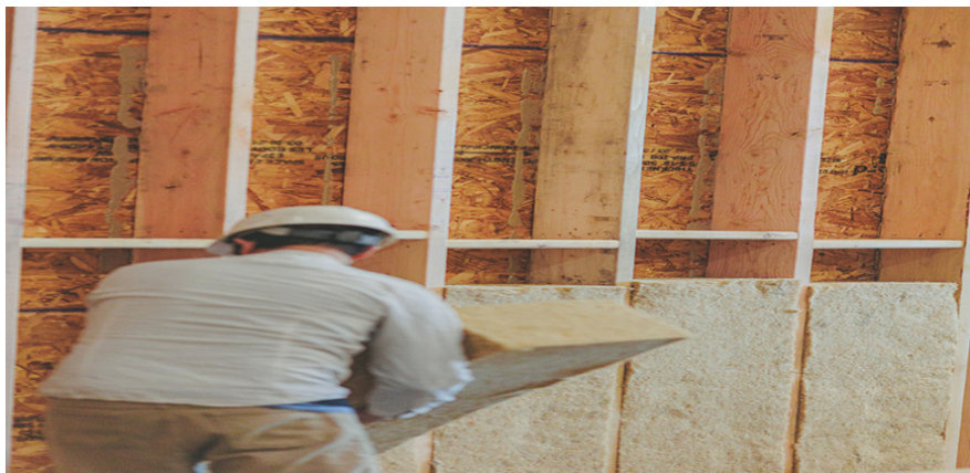
Figure I.26: Panneaux isolants en chanvre utilisés dans la Maison Éco-Logis, France [23]
