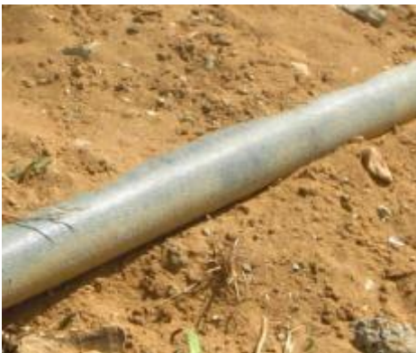
Fig.IV.5. Photo de conduite en PVC.
