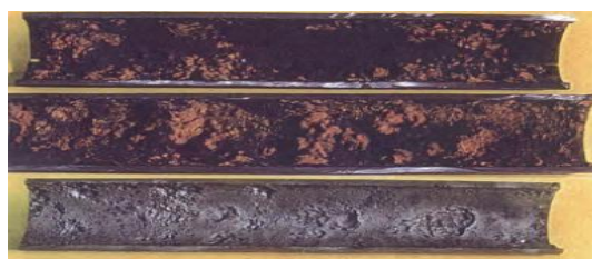
Fig.II.3. Corrosion de l'intérieur
