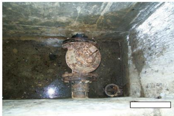
Fig.V.2. Photo de vanne.
