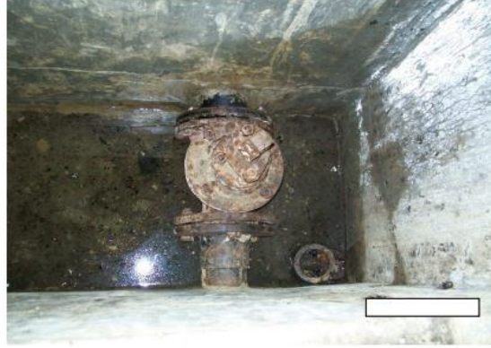
Fig.IV.4. Photo de vanne.
