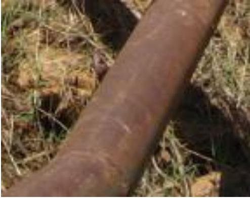
Fig.IV.3. Photo de conduite en acier.
