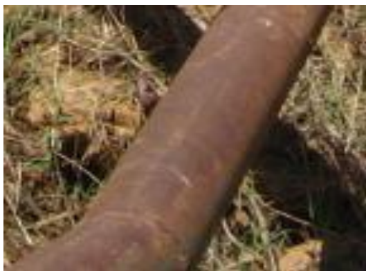
Fig.V.1. Photo de conduite en acier.
