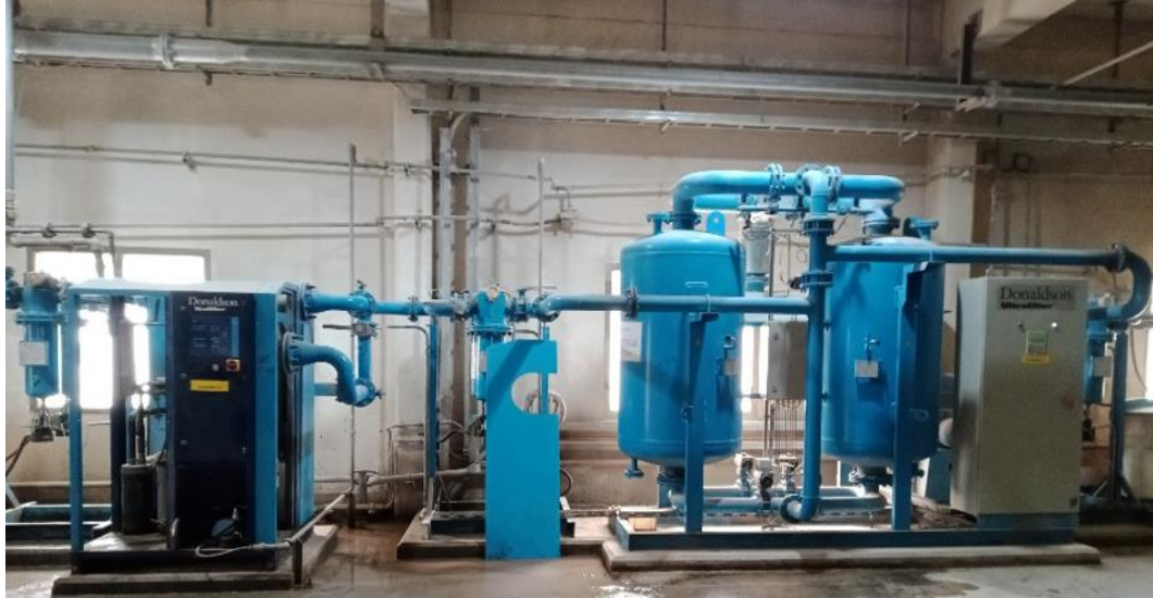
Figure II.22: Sécheur d'air comprimé [9].
