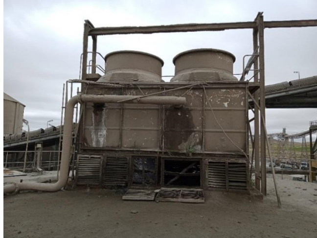
Figure II.26 Station de traitement d'eau [9].
