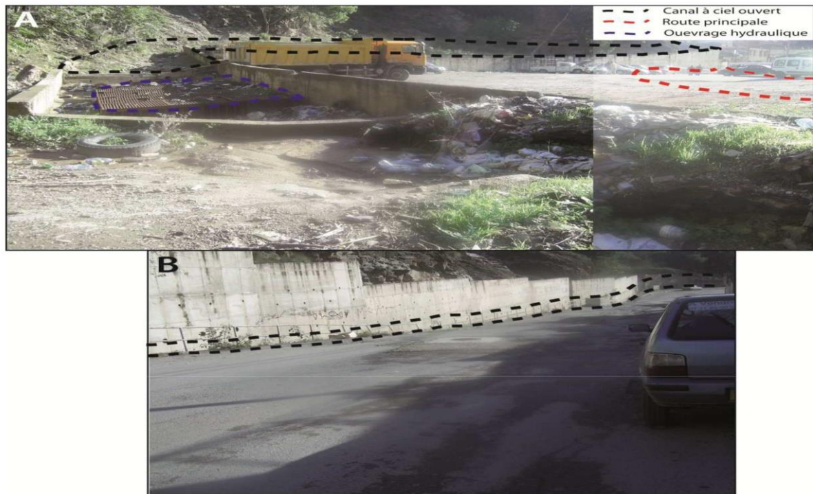
Fig. 5.10. Collecteur à ciel ouvert. A : en aval de l'ouvrage Jaubert ; B : le long de la route qui traverse le quartier ; C : Encombres et embâcles formés par différents matériaux.
