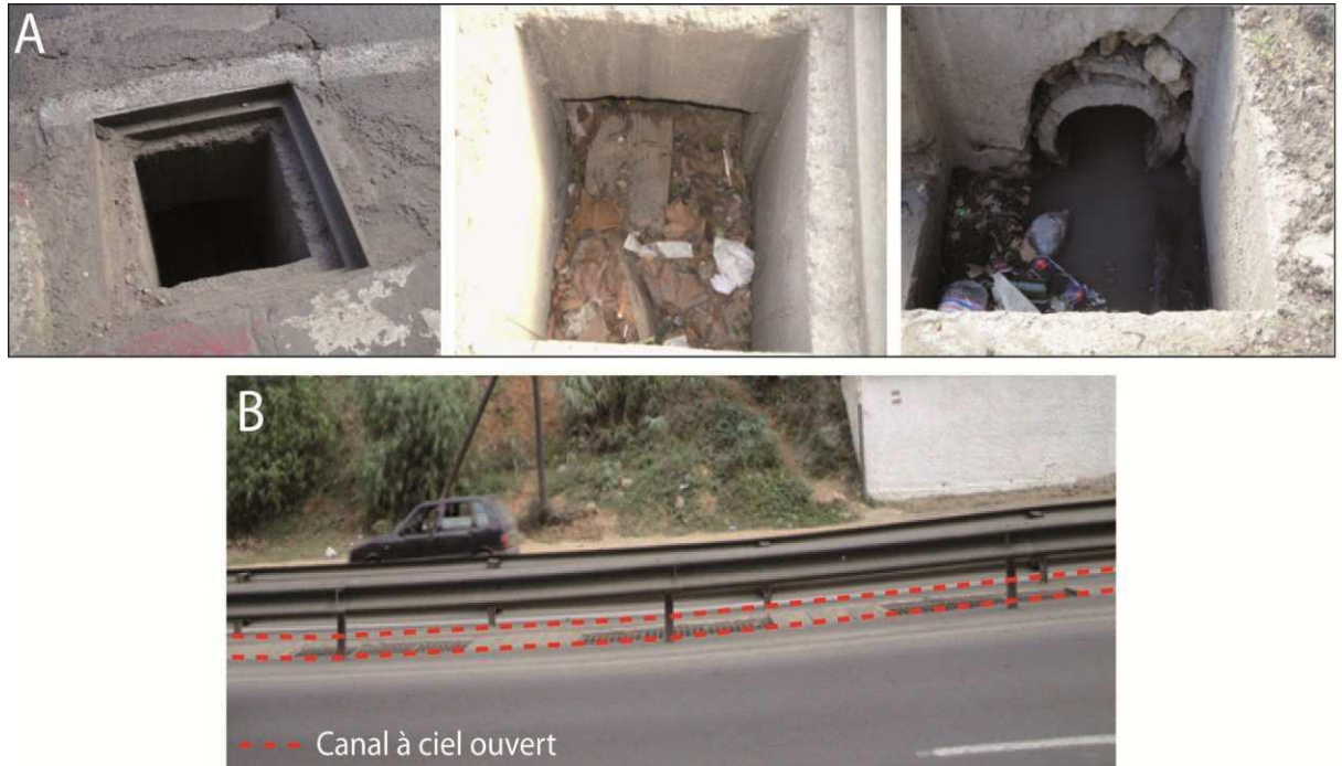
Fig. 5.33. Système d'évacuation des ruissellements de surface à partir de la voie rapide Chevalet-Triolet (A). Les avaloirs (B). Le canal à ciel ouvert.
