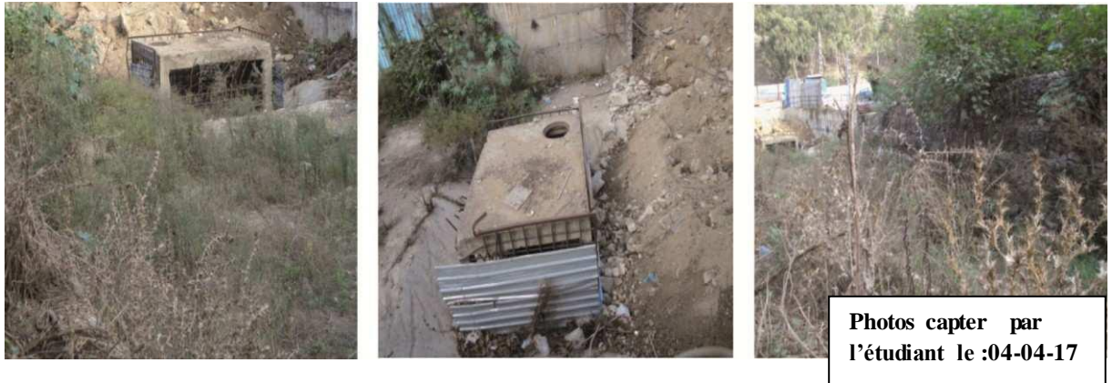
Fig. 5.6. Ouvrage hydraulique de réception de Frais Vallon
