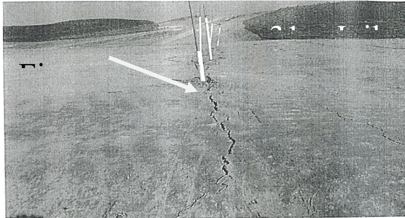
Figure.IV28. Apparition des fissures sur la surface du remblai d'une hauteur de 15m
