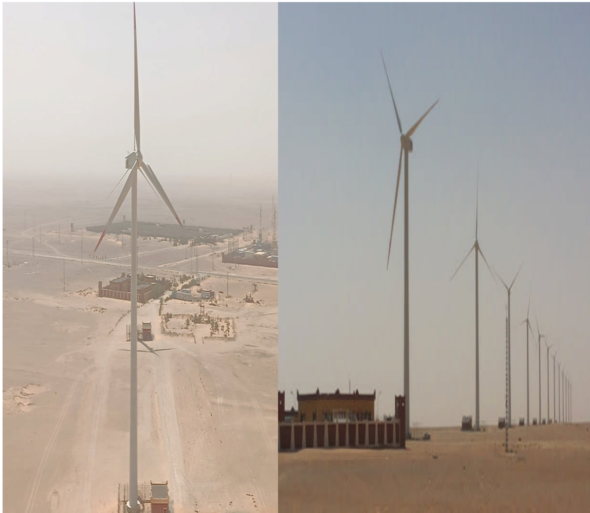
Figure I.4: Vue perspective générale de la ferme éolienne de KABERTENE [12].
