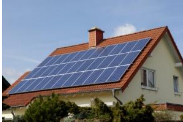
Fig.18 Générateur photovoltaïque intégré sur le bâti.
