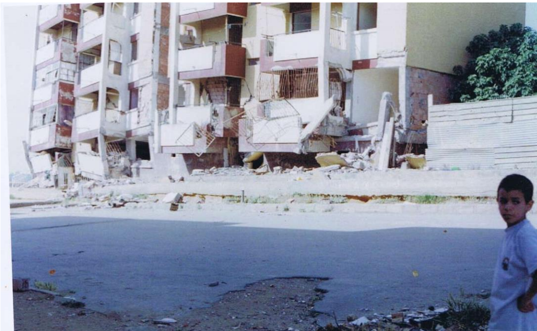
Figure 5-8 : RDC effondré et étages supérieurs intacts
