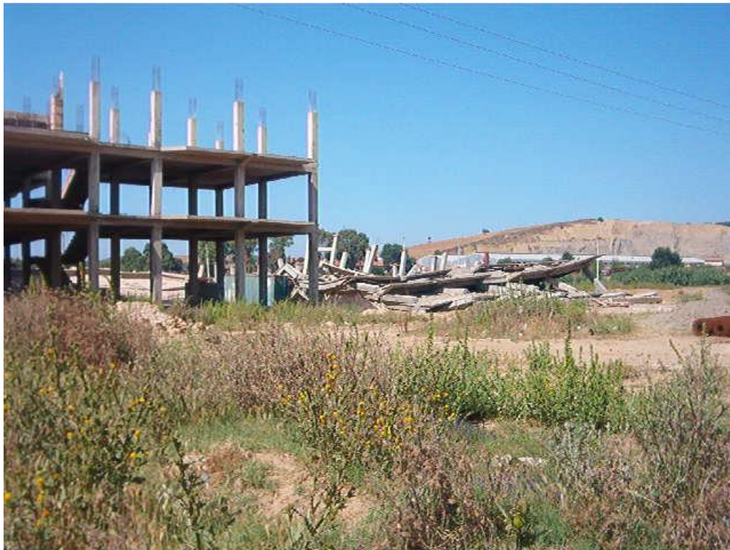
Figure 2-4 : Deux bâtiments en voie de réalisation, même site, même conception même qualité de mise en œuvre ont subi un comportement différent.
