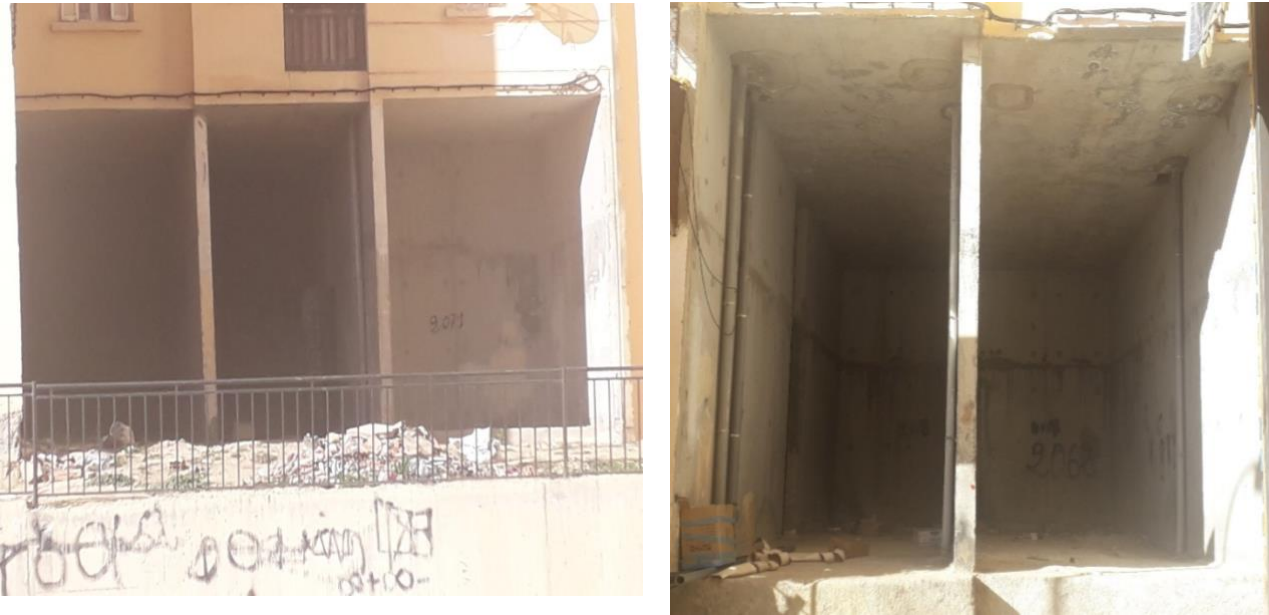
Figure 3-1 : Photos prises à la cité EL Baz à Sétif dans un immeuble de 9 étages, le RDC comporte des espaces qui ne conviennent à aucune activité, nécessitant la suppression du refend entre les deux espaces.
