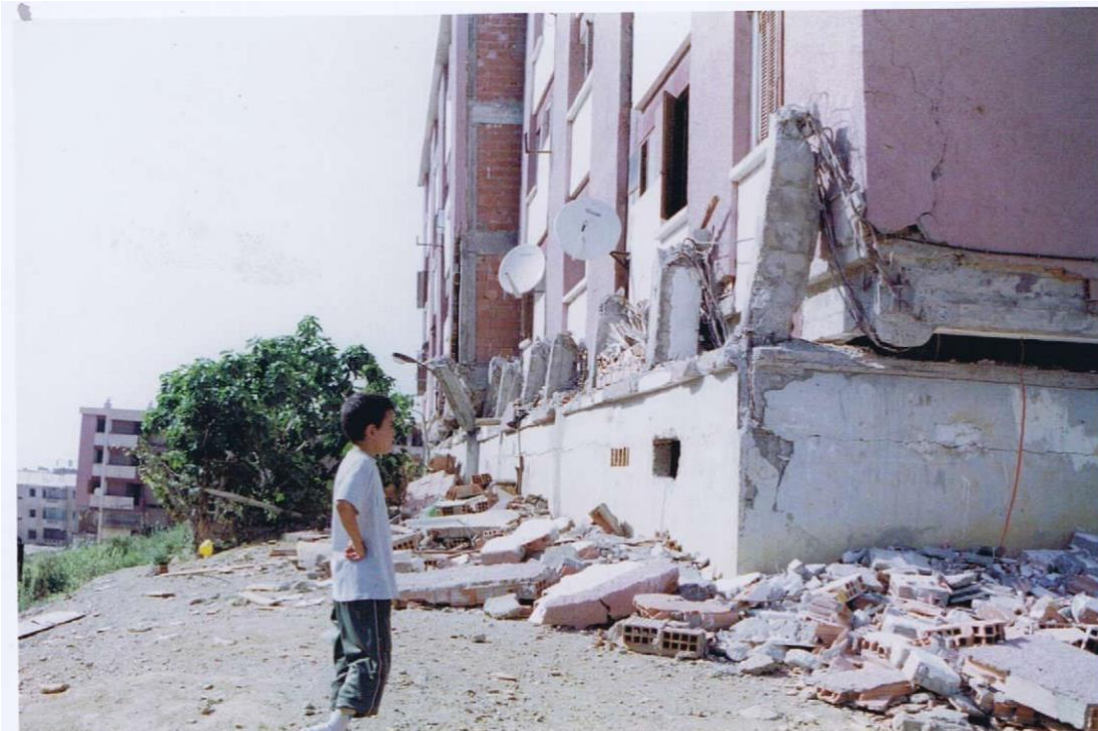
Figure 5-6 : la même photo du sort d'un RDC d'un bloc de bâtiment complètement rasé alors que les étages, comme on le voit se sont bien comportés.
