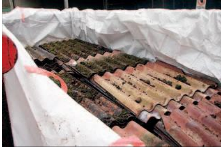
Photo 2.10- Plaques ondulées en amiante-ciment.
