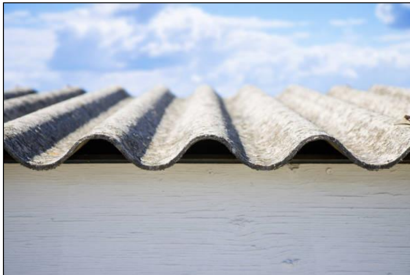
Photo 1.2- Plaques de toiture en Amiante dangereuses.
