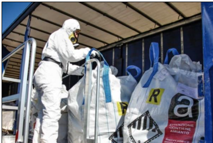
Photo 2.7- Emballage des plaques d'amiante dans un sac en plastique imprimé avec une étiquette d'avertissement .
