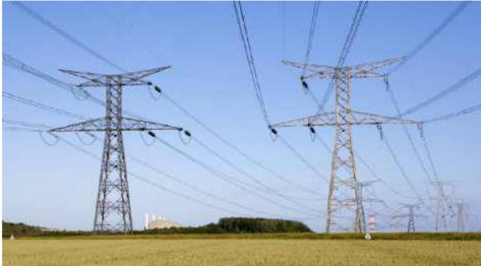
Figure II.5 Photo des lignes aériennes [12]
