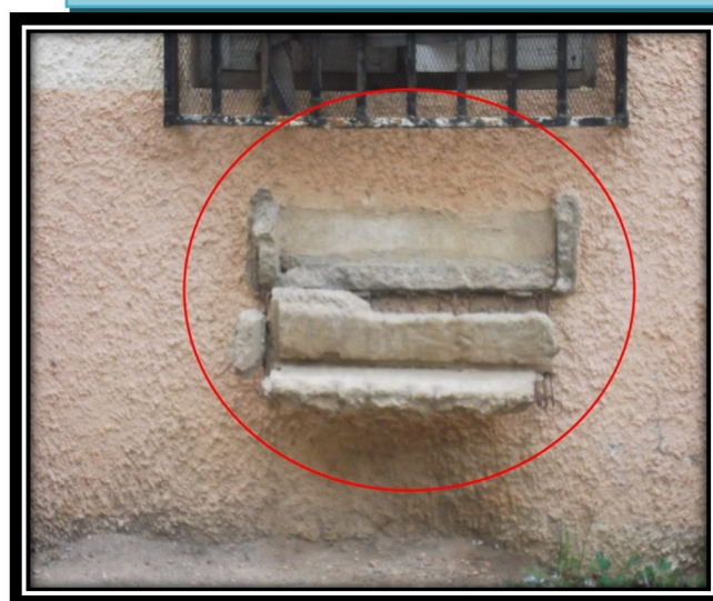
الصورة رقم 10: أحواض أزهار تالفة
