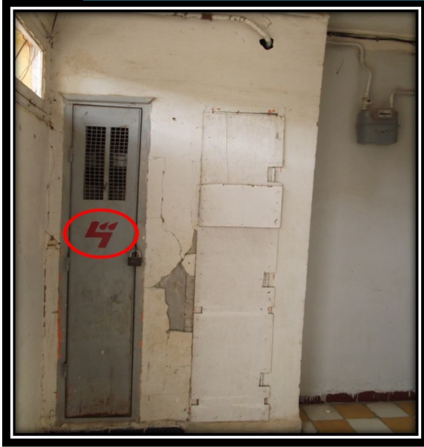
الصورة رقم 33 : عداد الكهرباء
