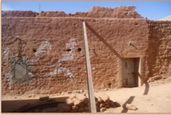
الصورة رقم (33): منزل في حالة رديئة
