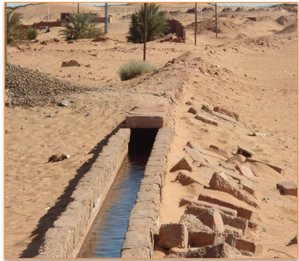
الصورة (56) : تجمع الرمال على حواف الساقية المصدر : التقاط الطالب 2015
