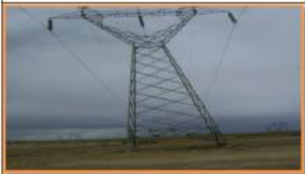
صورة 23.3: خطوط الكهرباء
