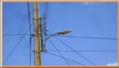
صورة 12.3 : شبكة الكهرباء
