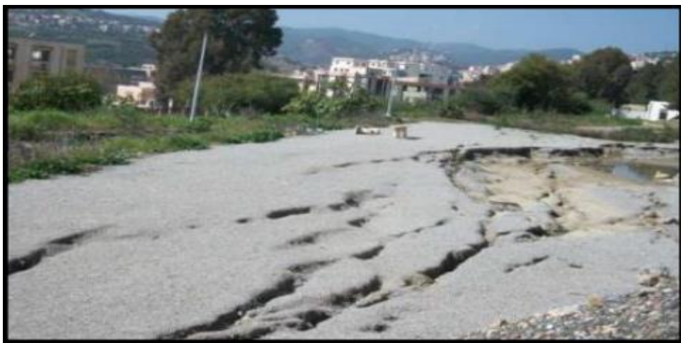
Figure I.7 : Fissures, tassements sur la plateforme du stade à Bejaia.
