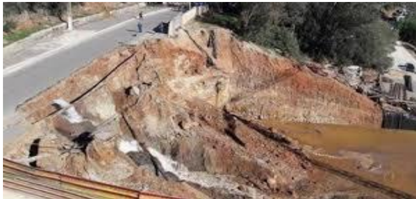
Figure I.8: Glissement de terrain sur la Route coupée à Bouzaréah.
