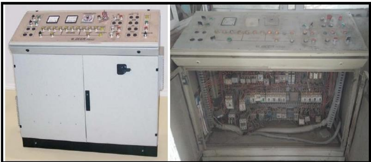
FIG ( II - 10 ) : Armoire électrique de la presse
