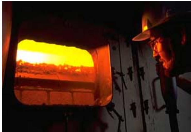
Figure 1.12 : Brûleur de la centrale à bagasse (résidu de la canne à sucre) à Bois Rouge sur l'île de la Réunion © V. Paul/Médiathèque EDF/Graphix
