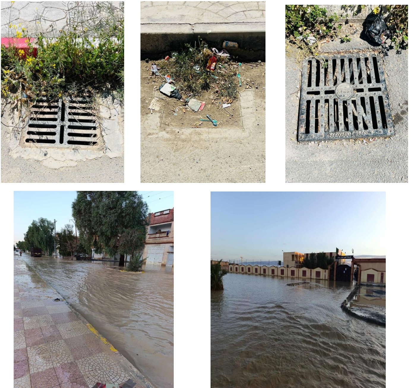
Figure 3.2: Photos de l'état actuel de quelques avaloirs de la zone d'étude
