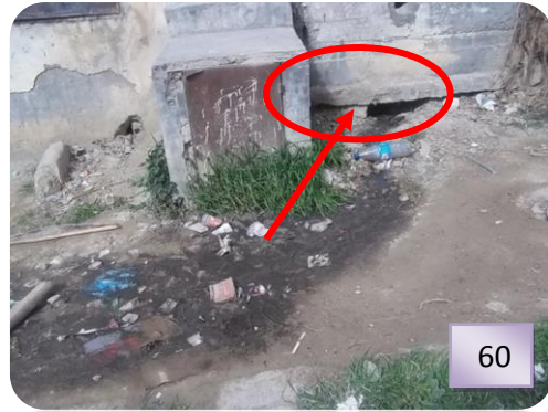
صورة رقم (60): تسربات المياه القذرة
