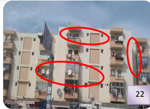
صورة رقم(22):الاكثار من الهوائيات يشوه الواجهة
