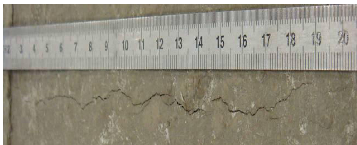
Figure 2.21 : Fissure de retrait de plastique [96]
