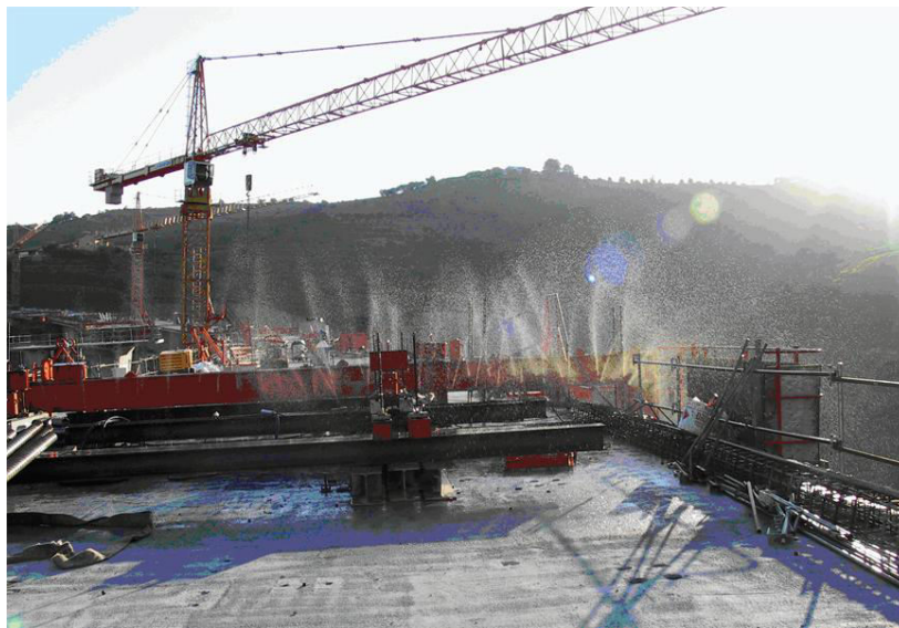
Figure 2.15 : Exemple de cure à l'eau du tablier d'un pont La maîtrise de la fissuration à jeune âge [95].
