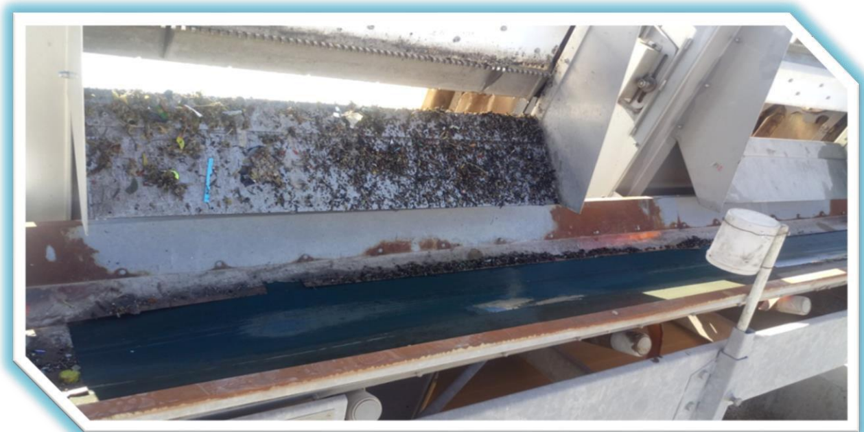
Fig.II.2 : Les dégrillage grossières.[59]
