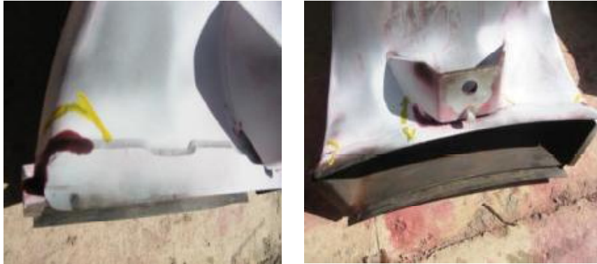
Fig III.1 Fissures sur les pièces de transition
