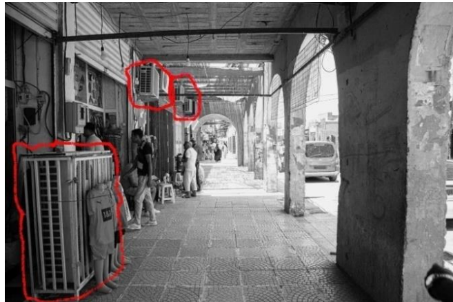
الصورة (07) تبين التثبيت غير الصحيح لأجسام أجهزة التكييف داخل الممرات المغطاة مما يسبب ارتفاع في الحرارة داخلها وانبعاث للغازات الضارة.
