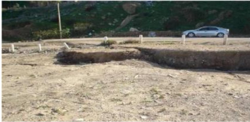
Figure I.19. Le glissement de la route des abattoirs.
