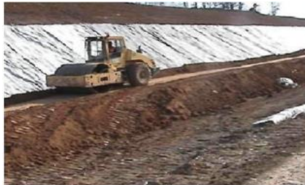
Figure I.32. L'utilisation du géotextile en jouant un double rôle le drainage et le renforcement du talus.
