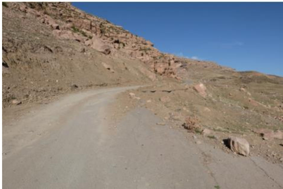
Figure 3.2. Vue de la route avec la zone où les instabilités sont visible
